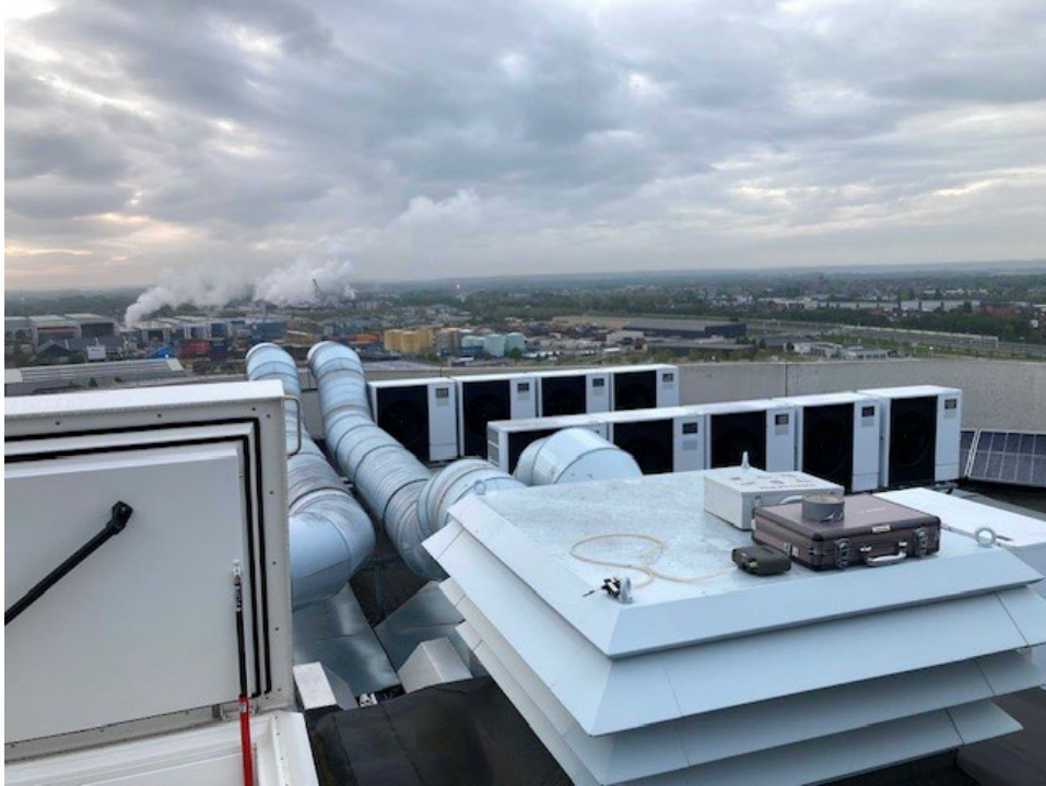
Foto 3.3. Meetlocatie 3 Manhattan tower op dak.
